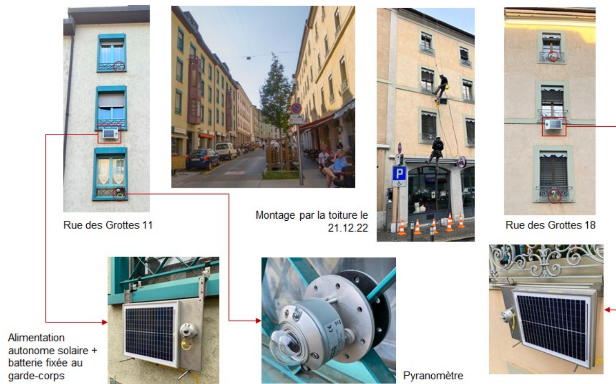
Figure 33. Installation des instruments de mesure en façade aux n°11 et 18 rue des Grottes
