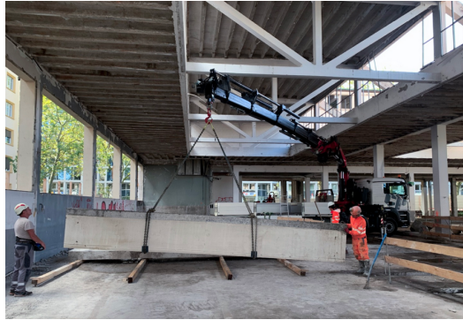
Fig. 5 : Photo du levage d'un sommier, projet C © Commune de Meyrin, ATBA, Atelier d'Ici, ZS, Sotrag SA, Construction Perret SA, Labotech
