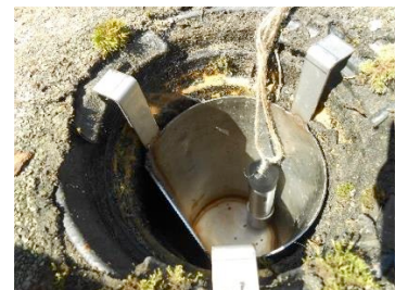
Figure 3. Déversoir cylindrique pour mesure de débit sur toiture
