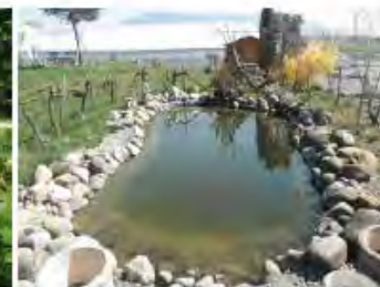
De mauvaises conditions pour l'expression de la biodiversité avec une bâche d'étanchéité non recouverte de substrat (visible au premier plan) et des berges entièrement minéralisées, rendant impossible toute implantation végétale.
