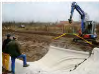
Pose d'une étanchéité artificielle de type bâche contenant de l'argile expansée (bentonite).
