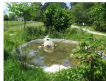
Cette bâche d'étanchéité mal posée empêche tout développement d'une végétation typique (hélophytes) sur son pourtour; la zone d'interface qui présente le plus fort potentiel pour la biodiversité est rendue stérile et la qualité esthétique de l'aménagement est péjorée.
